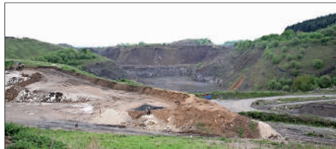
Die Bildmitte bietet einen Einblick in den derzeit noch im Basaltabbau befindlichen ersten Teil des 7. Bauabschnitts der Deponie.
